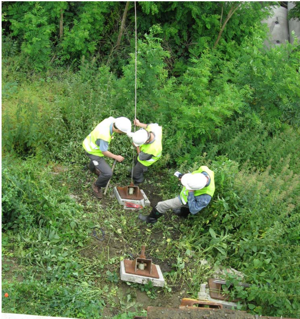
Figuur 9. Installatie van optische vezel en injectiesysteem in een jet-grout nagel te Ottignies.
